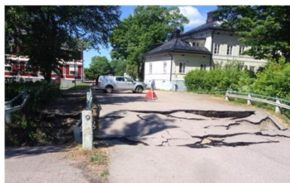
Slukhål efter läcka - bro nära att rasa
